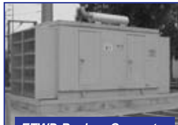
ETWD Backup Generator
